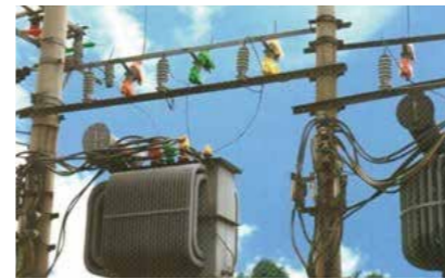
变压器进出线保护罩和跌落式熔断器保护罩在变电线路中的实际应用
